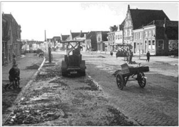
Afb.12: De gloednieuw geïnstalleerde benzinepomp ter hoogte Nieuwstraat nr. 17 (aug. 1950).
