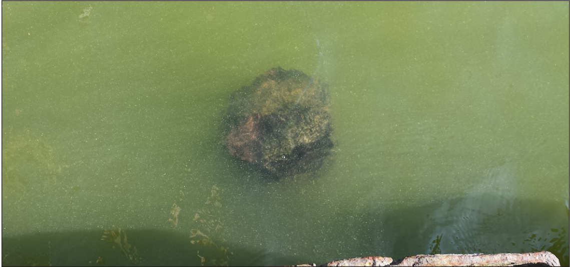
Afb. 14 Een van de wormspijkerpalen direct onder de waterlijn.
