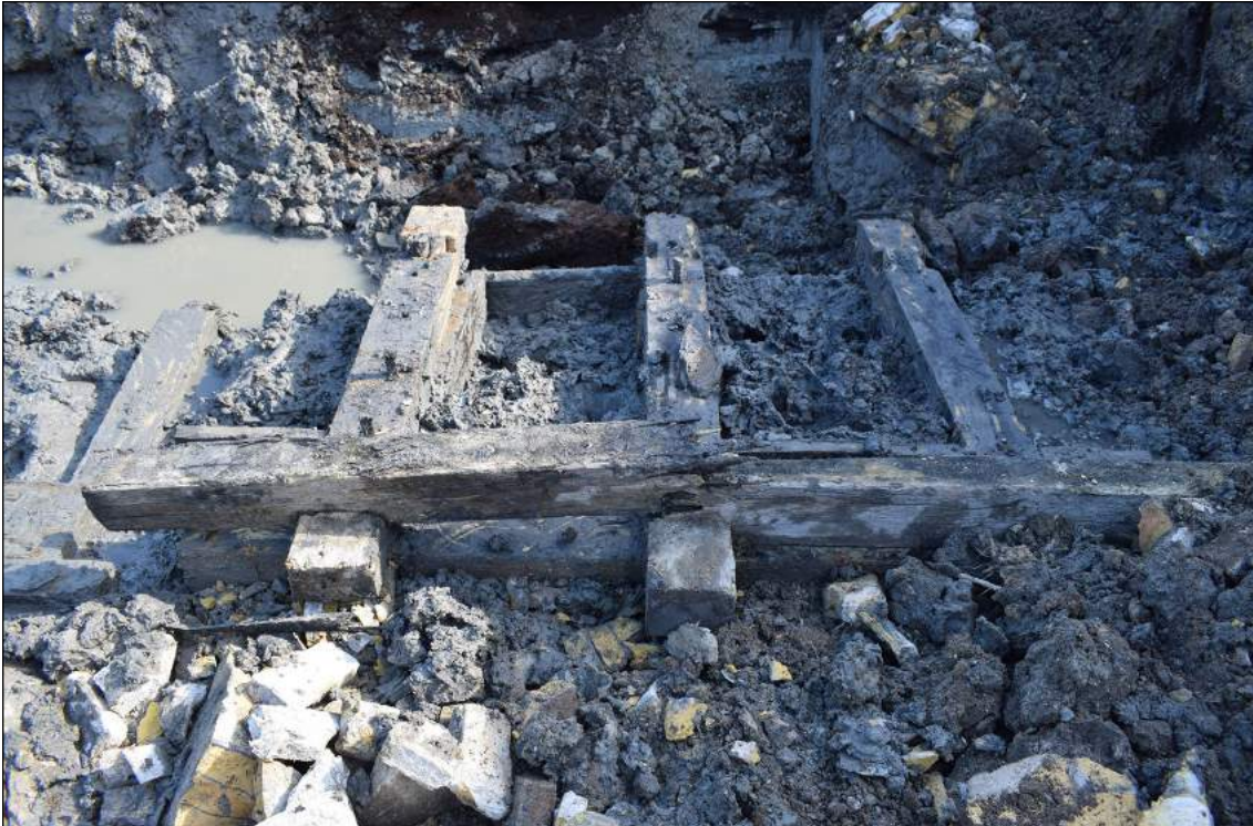
Afb. 4.49. Detail van de hoger liggende houten fundering van de vleugelarm met de halfhoutverbindingen.
