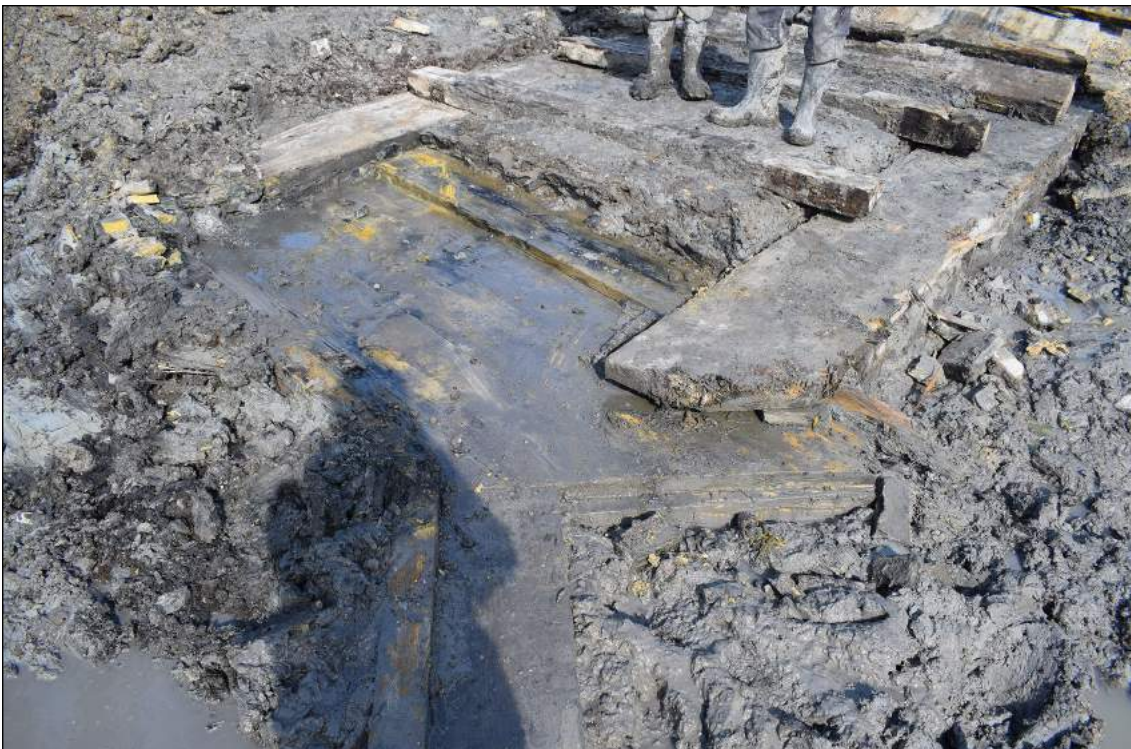
Afb. 4.50. De zandstrook lag op een inkeping van de houten funderingsvloer van de vijzelbak.
