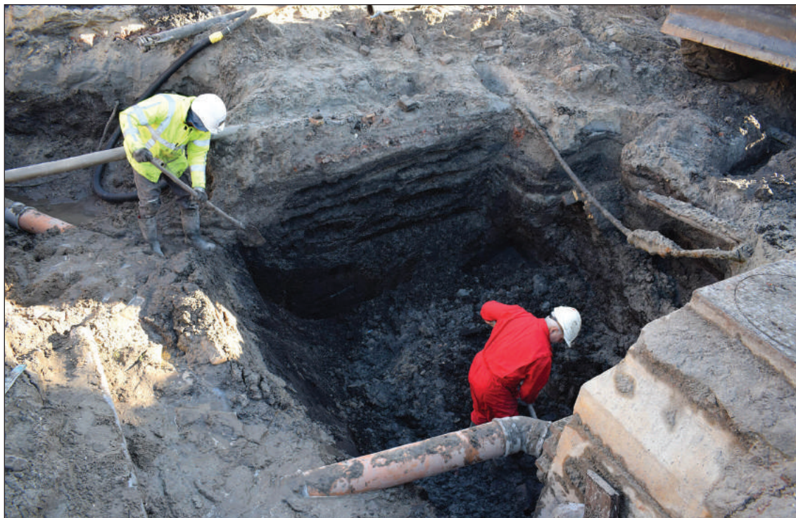
Afbeelding 14. Graafwerkzaamheden op de kruising Oude Haven – Koningshof. Links wordt een deel van het archeologische profiel afgewerkt. Rechts wordt het riool aangelegd.
